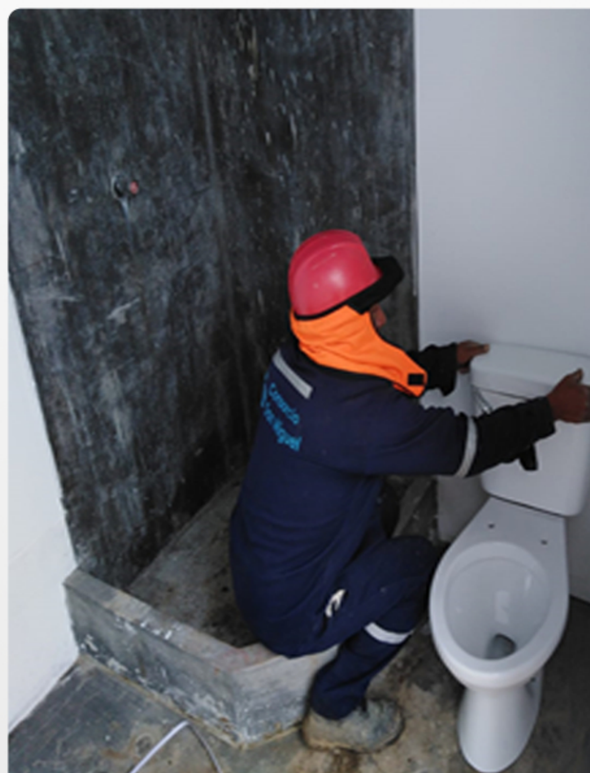
INSTALACIONES SANITARIAS EN UBS
