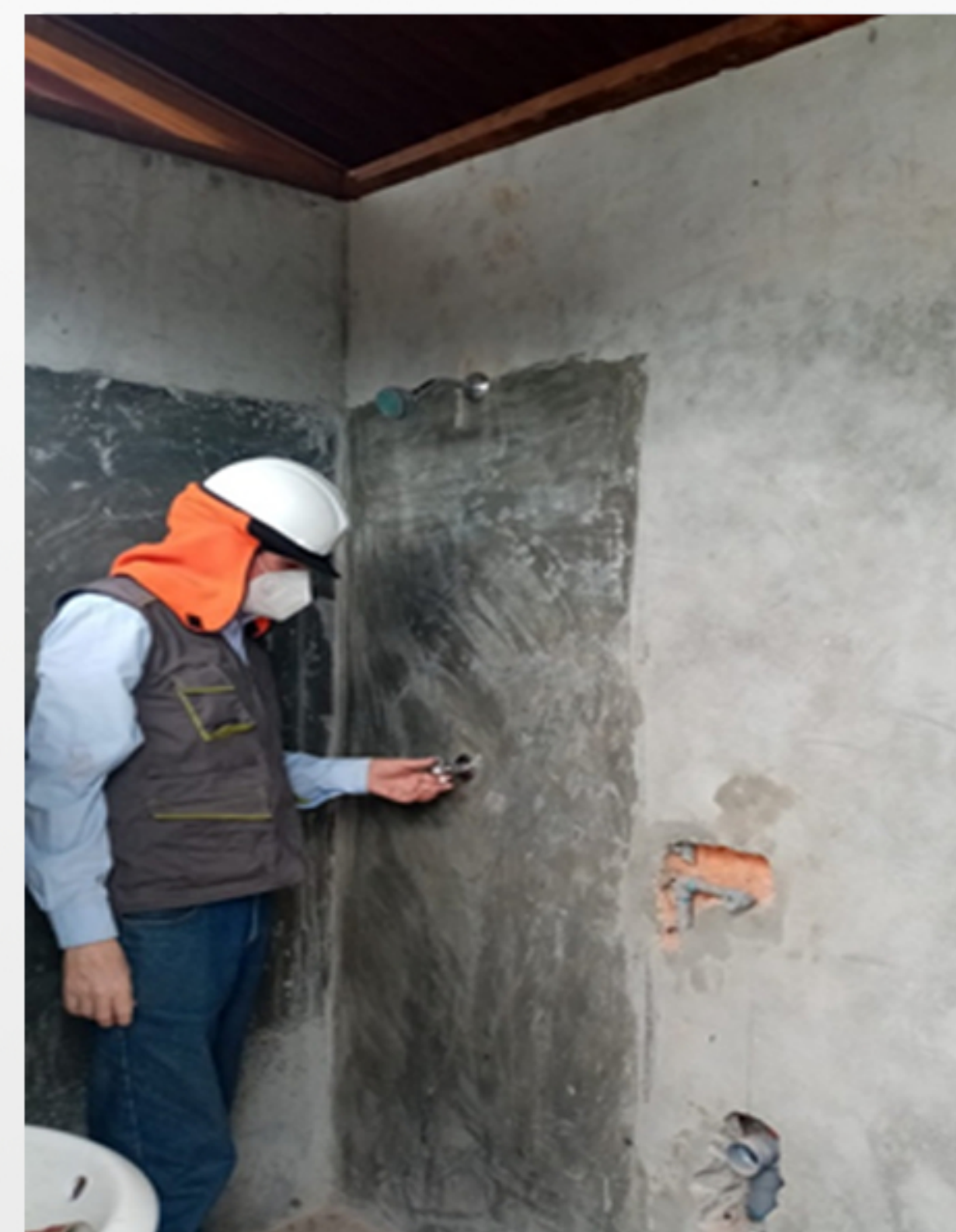
VERIFICACIÓN DE INSTALACIONES INTERNAS DE UBS
